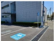
上里町役場EV充電スタンド
