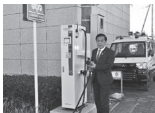
▲EV車充電設備 (役場庁舎北西駐車場)
