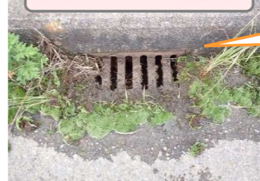
排水ますの土砂詰まり
