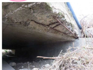
補修前 コンクリート内の鉄筋露出
