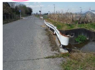
補修前 防護柵が変形
